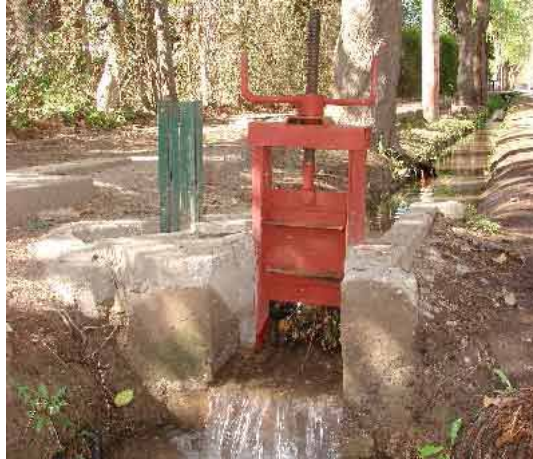
Sistema de riego de oasis. Compuerta y acequia.
